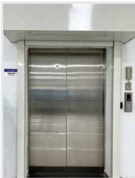
Bảo vệ cửa tầng thang máy
