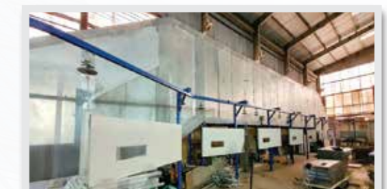
Hệ thống sơn tĩnh điện Xuất xứ: VIETNAM
